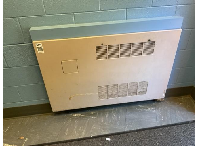
20 - FAN COIL UNITS
